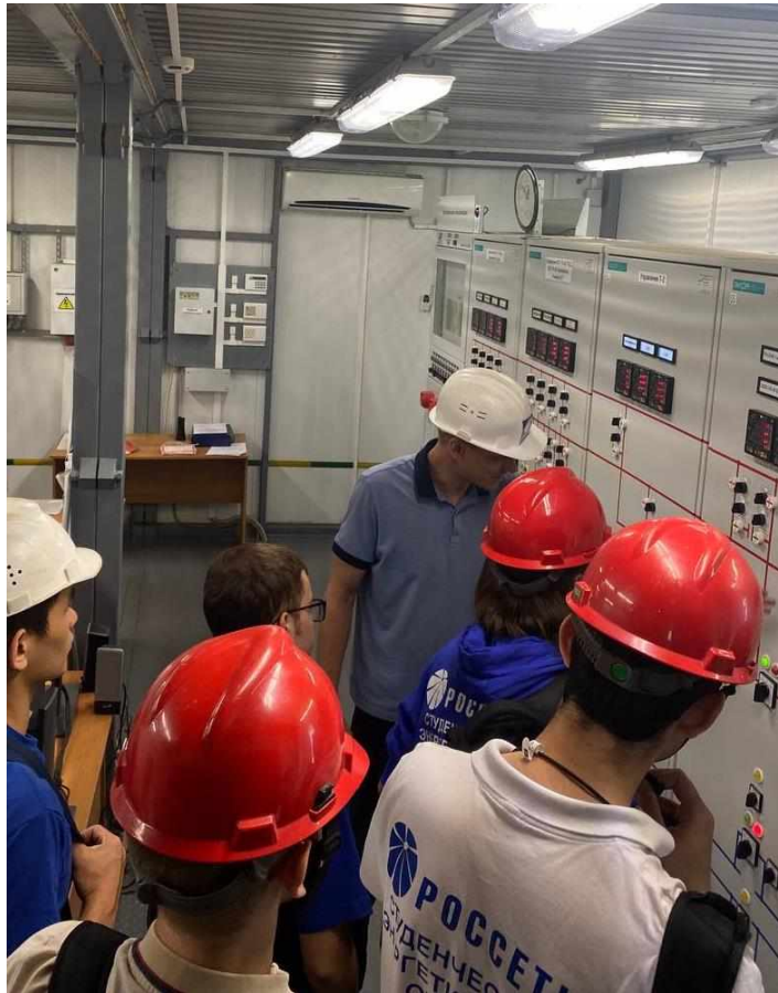
Рис. 36. Отряд «Импульс». Плановый технический осмотр вводно-распределительного устройства.
